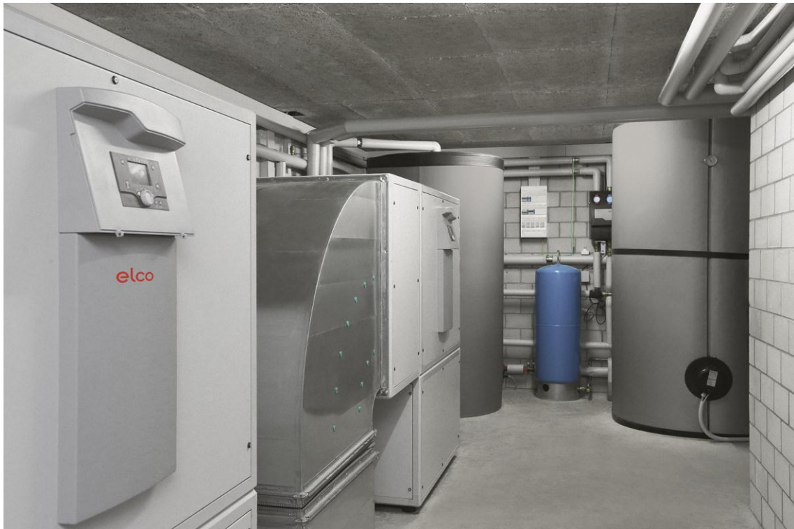
Scorcio nel locale tecnico con le termopompe (a sinistra), l'accumulatore tampone e l'accumulatore ACS.
