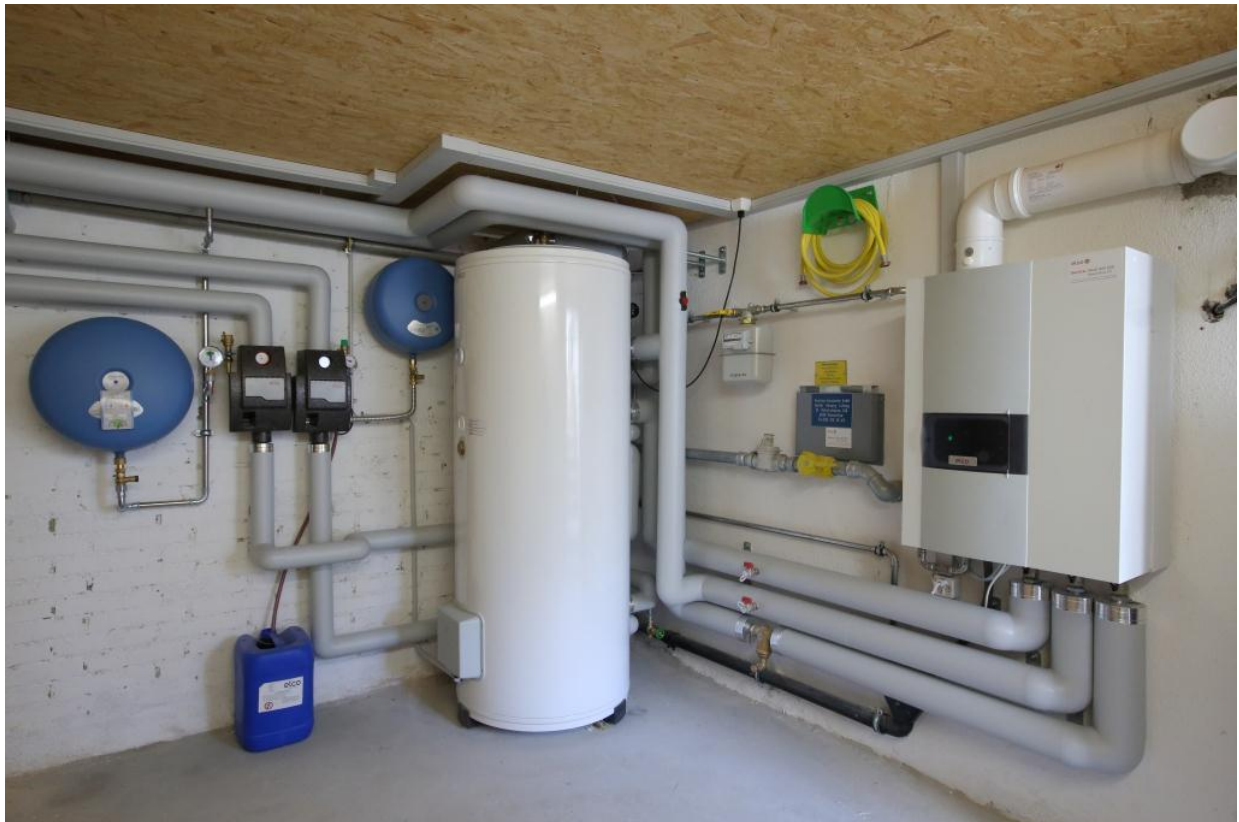
Vista della sala caldaia contenente la caldaia a condensazione a gas, lo scaldacqua adiacente e il gruppo pompa Solar.
