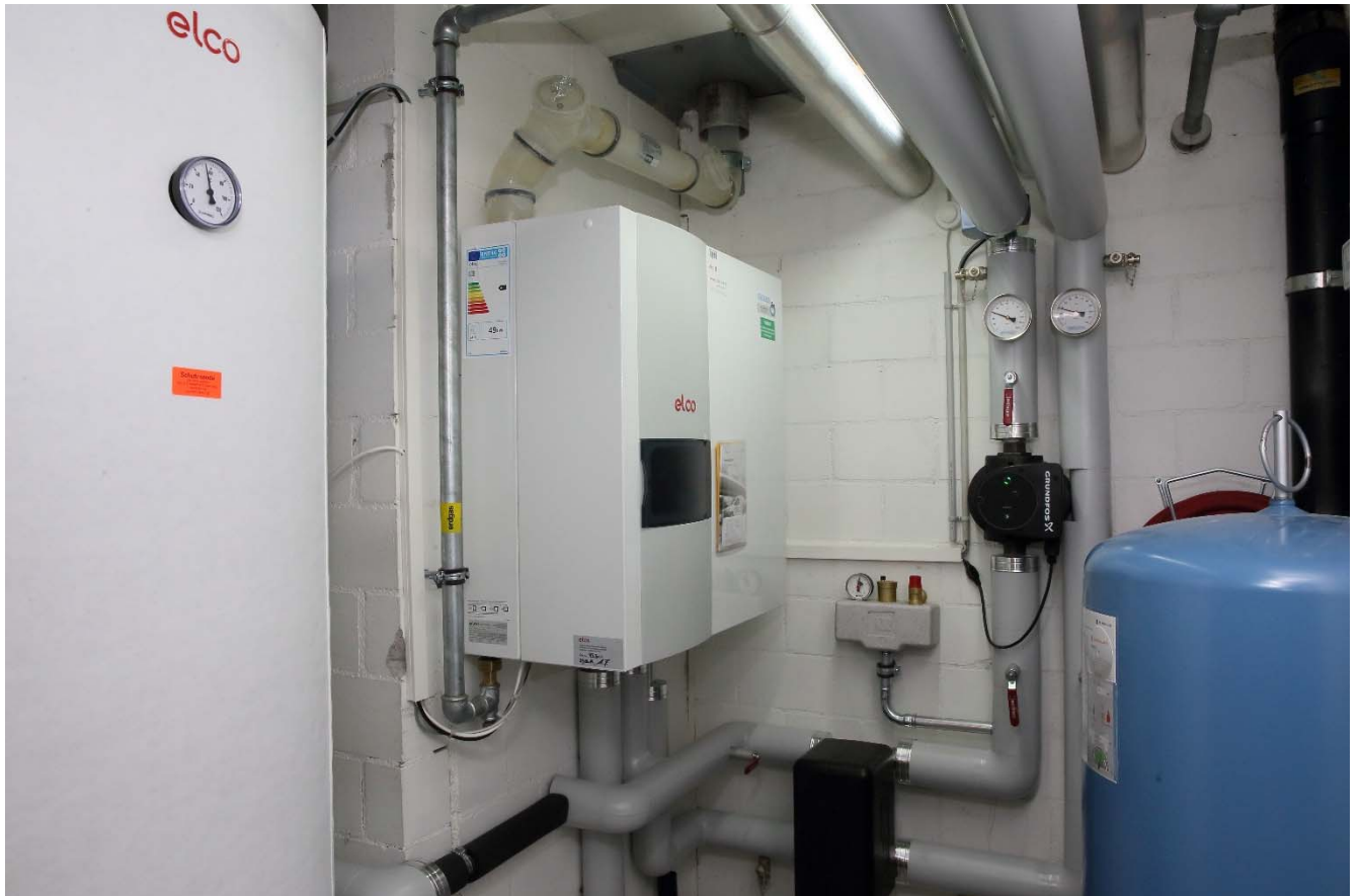
Scorcio del nuovo impianto di riscaldamento in una casa plurifamiliare con una caldaia THISION S 50.2.
