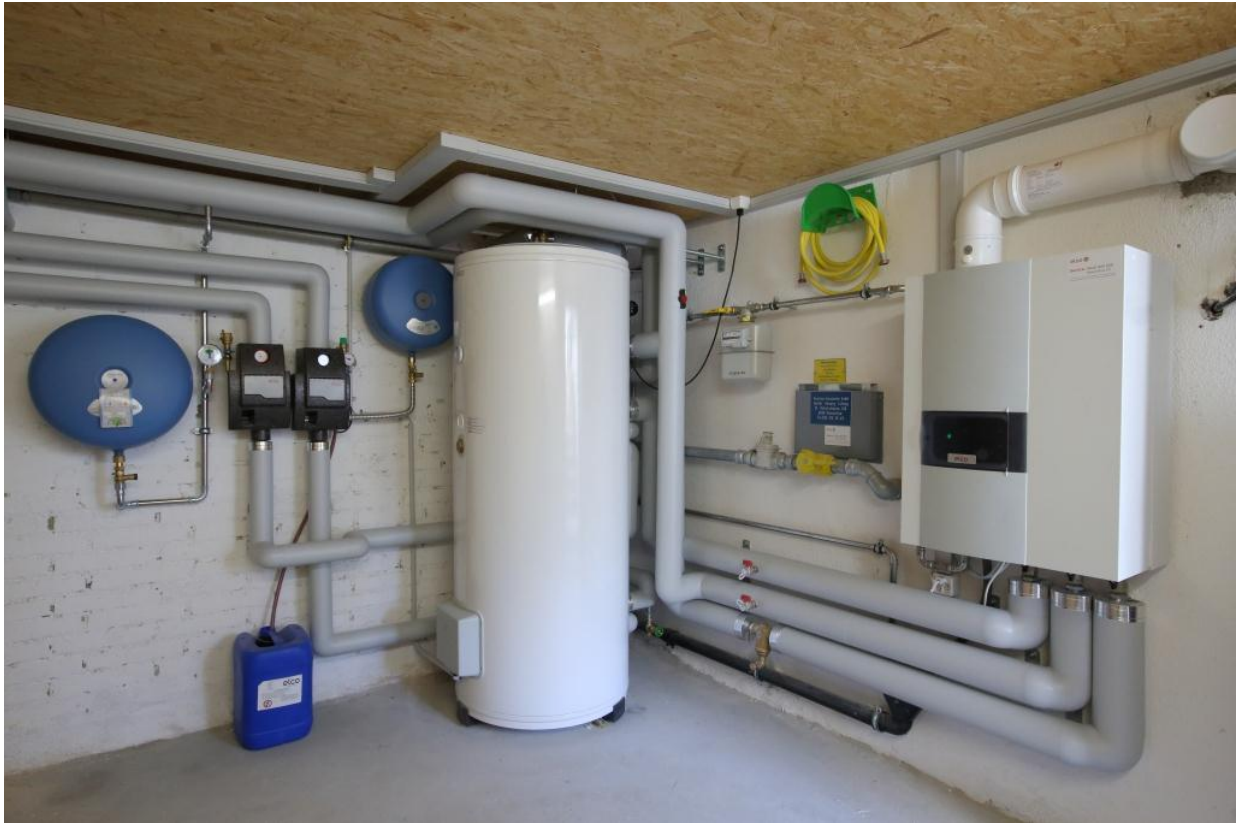
Aperçu de la chaufferie avec chaudière à condensation à gaz, à proximité le chauffe-eau et le groupe de pompes du chauffage solaire.
