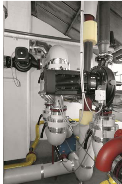
Bild 4: Die beiden Kreisläufe verfügen über je eine eigene drehzahlgeregelte Pumpe. In der Bildmitte die Pumpe für den Primär-, oben links für den Sekundärkreislauf.
