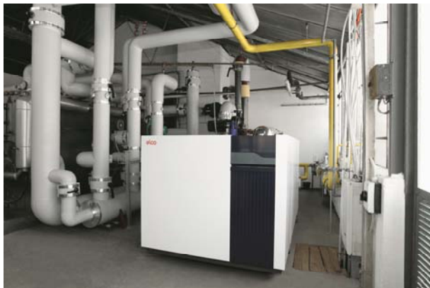
Bild 1: Blick in den Heizungsraum der Schäfle Rosen AG mit dem neuen Gas-Brennwertkessel RENDAMAX 3409.
