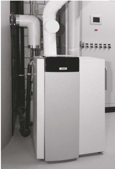
Bild 5: TRIGON L für die Arena Thun: Mit seinen kompakten Abmessungen benötigt der leistungsstarke Gas-Brennwertkessel wenig Platz.
