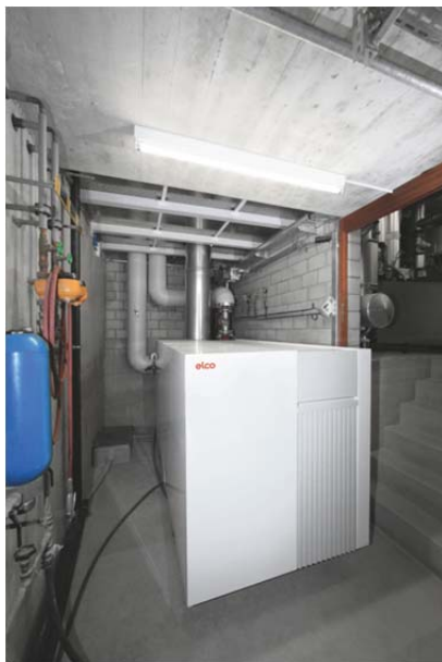
Bild 3: Blick in den Heizungskeller des Ziegelei-Zentrums mit dem neuen Gas-Brennwertkessel RENDAMAX 3602, der mit modernster Energiespar-Technologie ausgerüstet ist.
