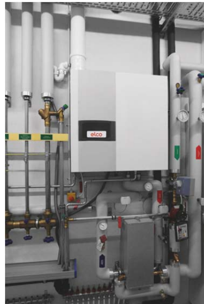
Bild 6: Dank grosser Modulation erreicht der Gas-Brennwertkessel THISION S hohe Jahres-Wirkungsgrade. Im Bild der THISION S 45 E des Fitnessparks.
