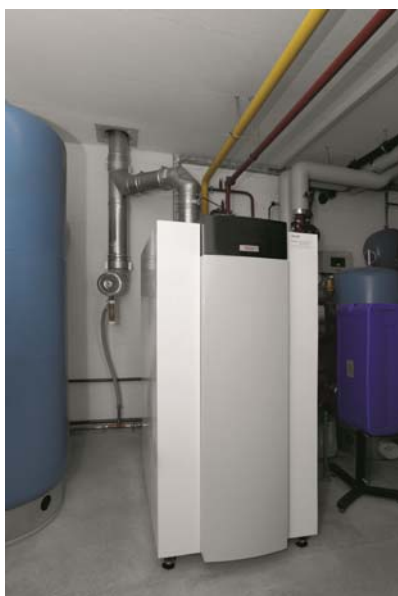
Bild 5: Mit dem Gas-Brennwertkessel R602 wird der Spitzenbedarf für Raumheizung und Warmwasser abgedeckt.
