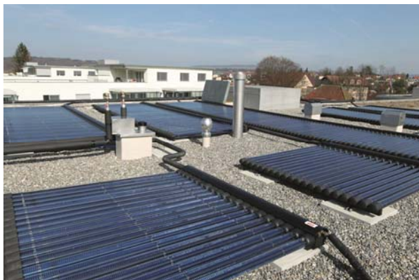
Bild 3: Insgesamt 150 m 2 Vakuumröhrenkollektoren des Typs AURON DF wurden auf den Flachdächern der vier Häuser installiert.
