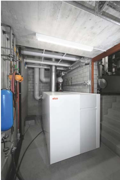
Figura 3: Scorcio del locale riscaldamento del centro Ziegelei con la nuova caldaia a gas a condensazione RENDAMAX 3602, dotata di un'ultramoderna tecnologia di risparmio energetico.
