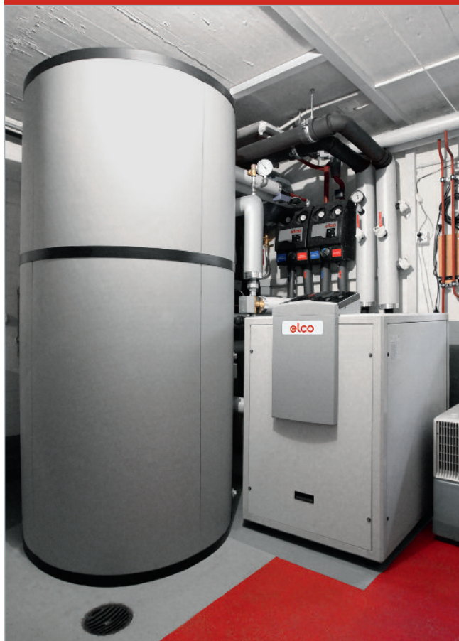
Une installation compacte à faible encombrement
