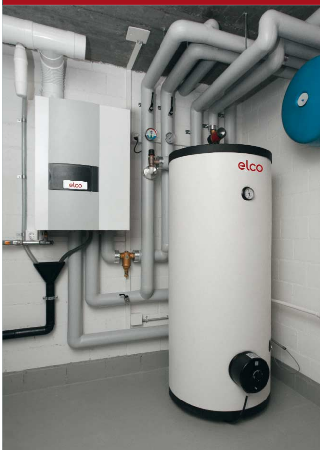
Coup d'œil sur la chaufferie
