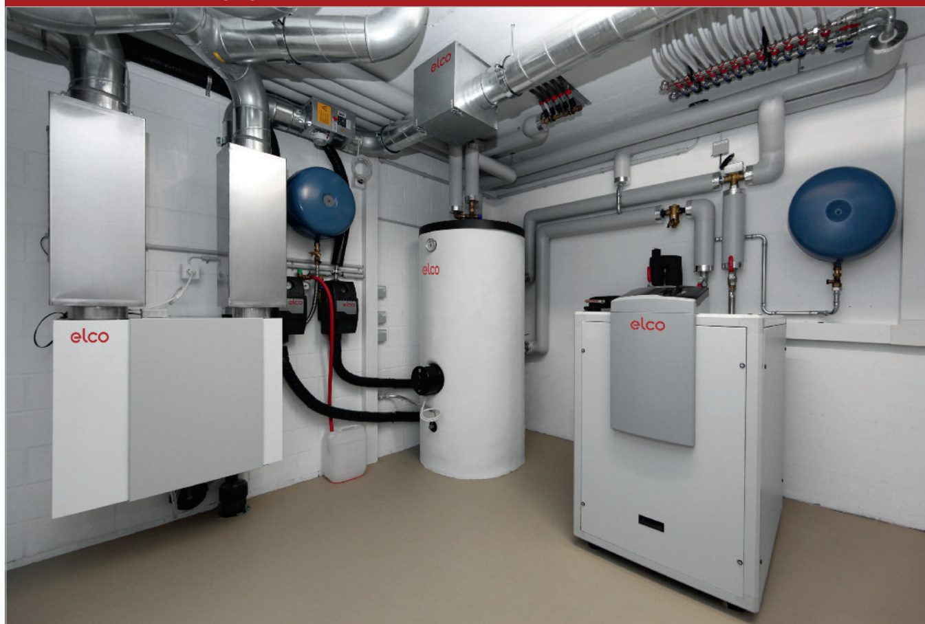
La ventilation de confort AIRSYSTEM, l'accumulateur solaire et la pompe à chaleur AQUATOP T de ELCO.
