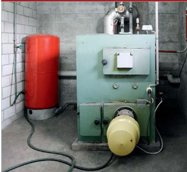
L'ancien chauffage au mazout servait de centrale de chauffe pour les 3 maisons en terrasse.
