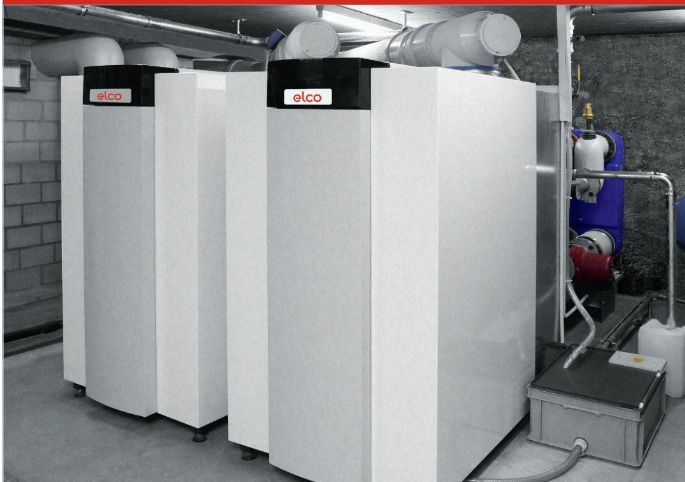
Moderna centrale di riscaldamento
