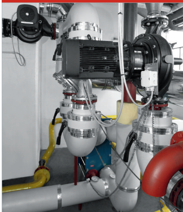
Due pompe a regime variabile: al centro dell'immagine, la pompa del primario, in alto a sinistra la pompa del secondario.
