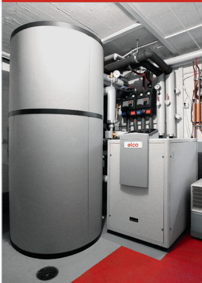
Installazione compatta di minimo ingombro
