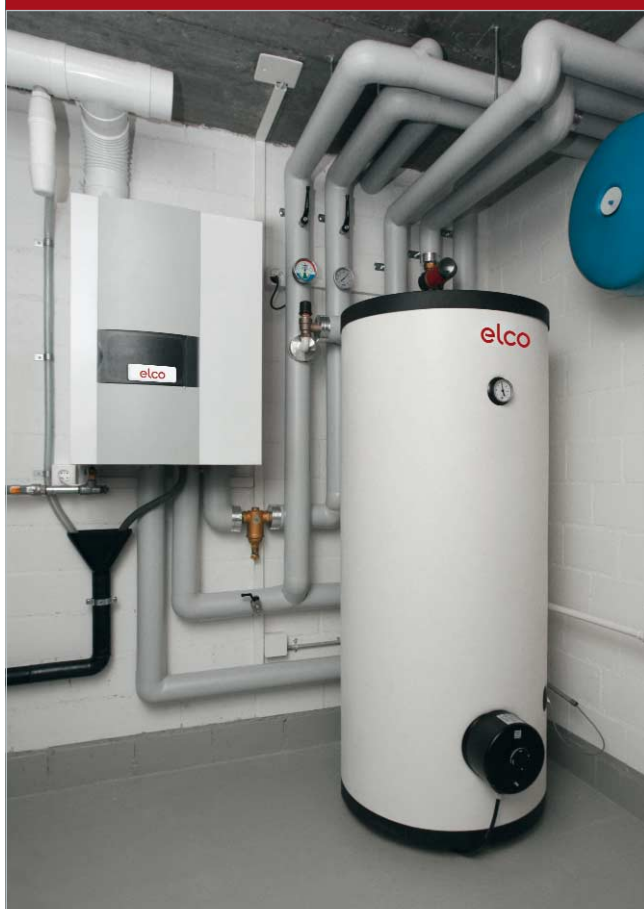
Scorcio del locale riscaldamento
