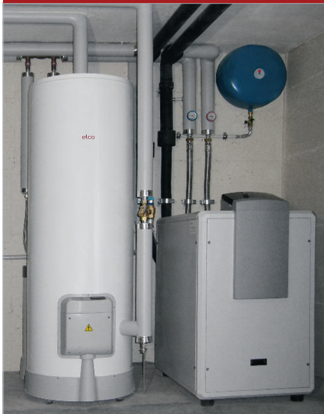
Uno scorcio sulla termopompa ELCO
