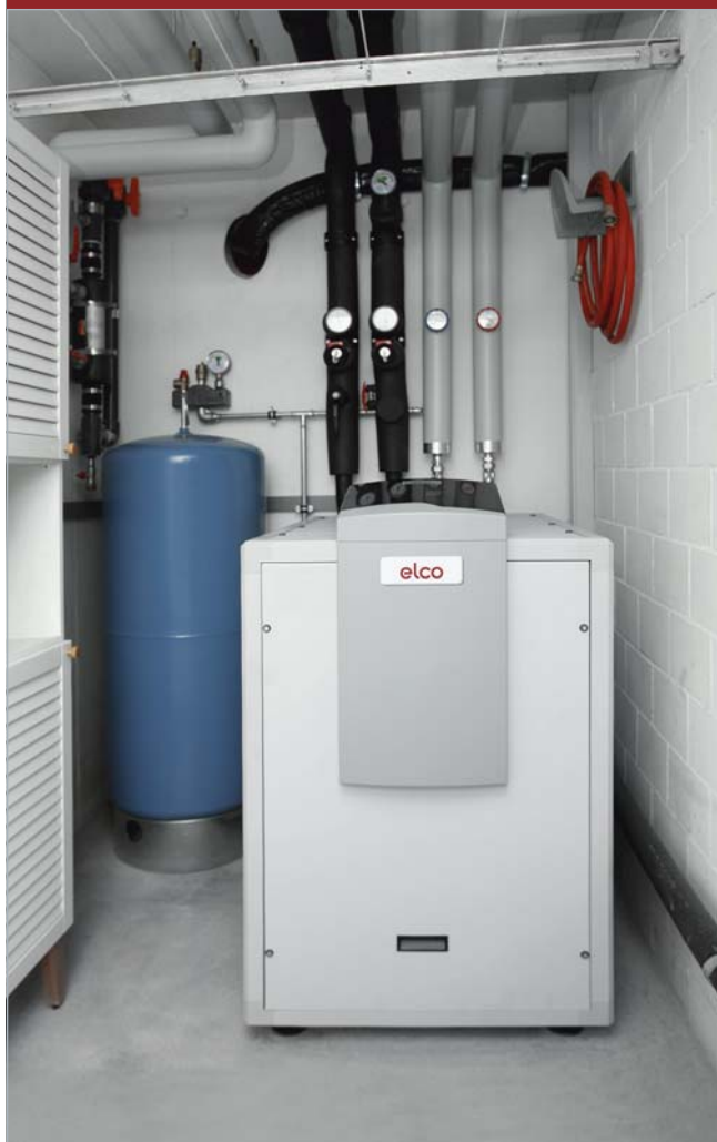
Ingombro minimo nel locale riscaldamento.
