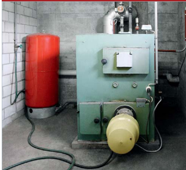
La caldaia a gasolio fungeva da centrale di riscaldamento per le 3 case terrazzate.
