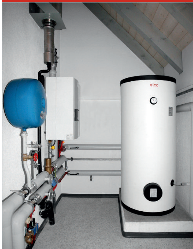
Scorcio del locale riscaldamento nel sottotetto
