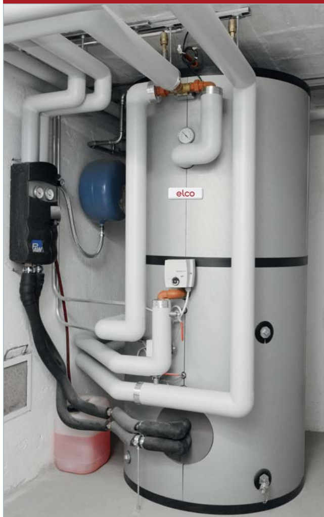
Speicher mit Warmwasserboiler
