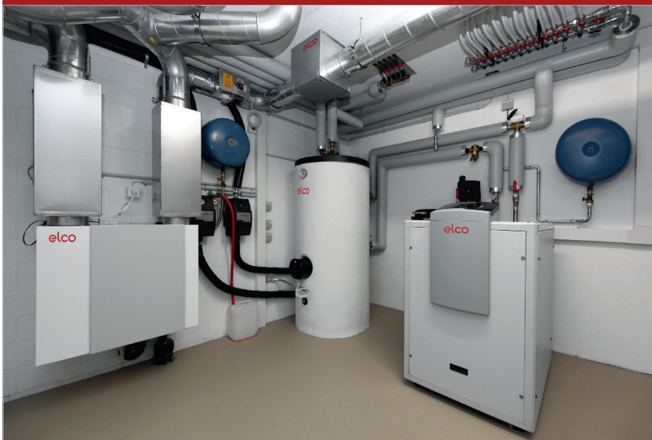
Komfortlüftung AIRSYSTEM, Solarspeicher, Sole-Wasser-Wärmepumpe AQUATOP T von ELCO.
