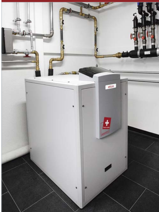
Wärmepumpe AQUATOP T mit Wärmetauscher (links), der die Temperatur des Erdsonden-vorlaufs erhöht.
