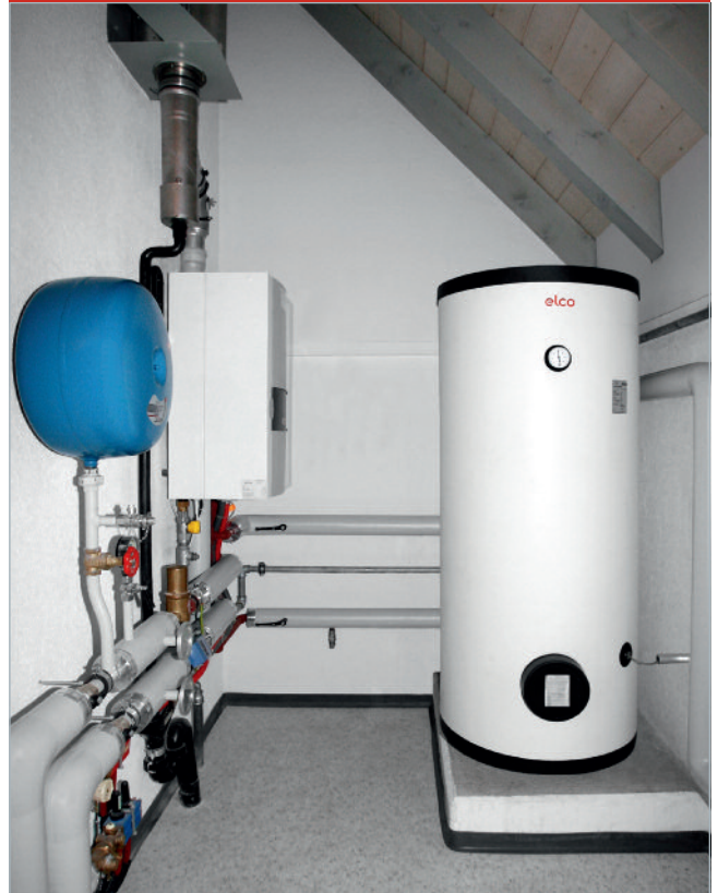
Blick in den Heizungsraum im Estrich
