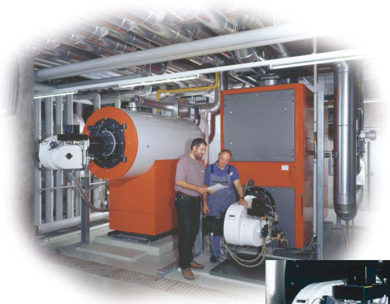
Installation mixte avec systèmes gaz et mazout
