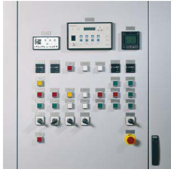
Individuelle Schaltschränke zur bedarfsgerechten Steuerung und Überwachung ganzer Systeme
