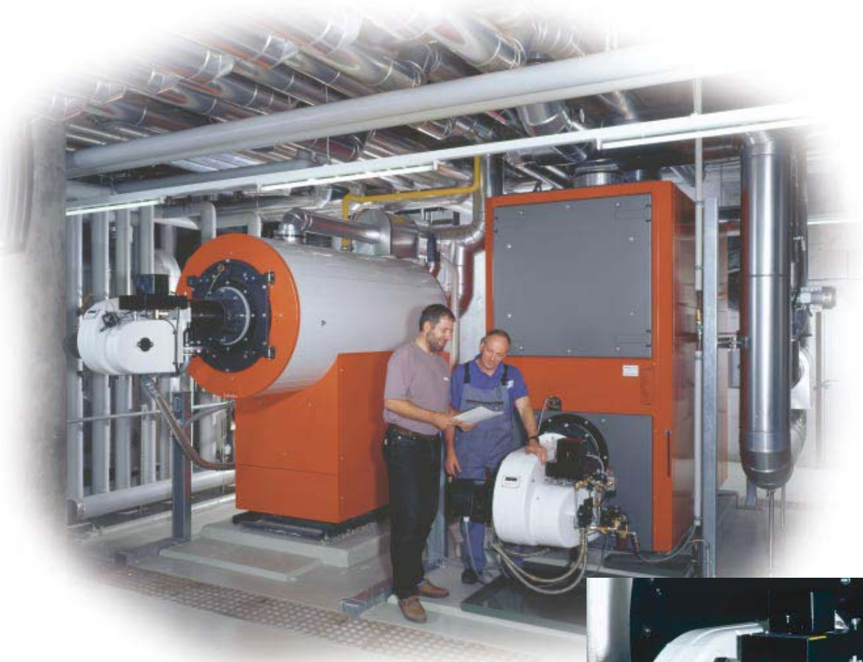
Kombinierte Anlage mit Gas- und Ölsystem
