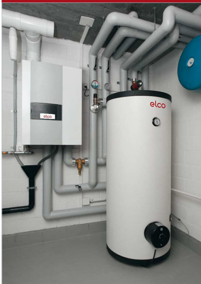
Blick in den Heizungskeller
