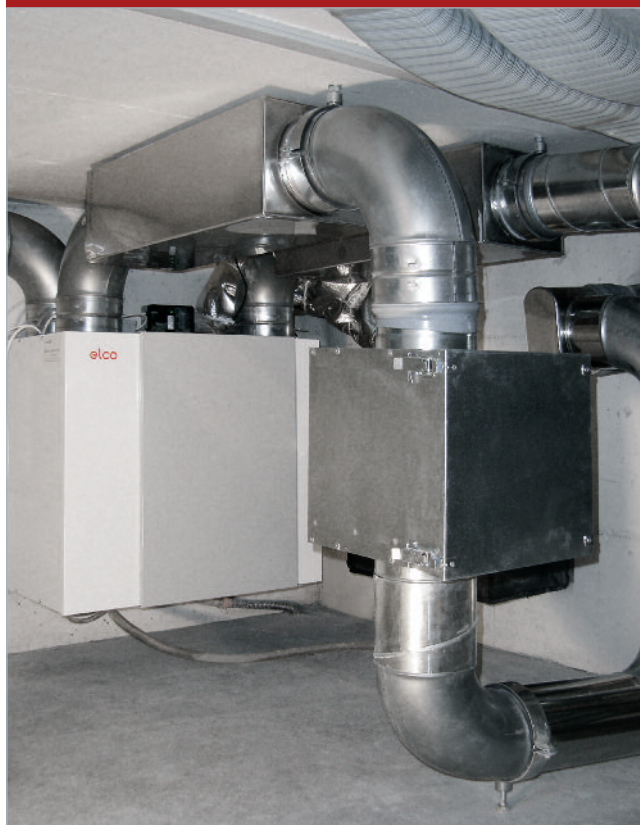
Blick auf die ELCO Komfortlüftung
