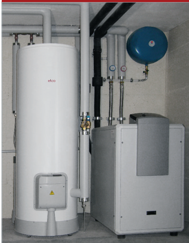
Blick auf die ELCO Wärmepumpe
